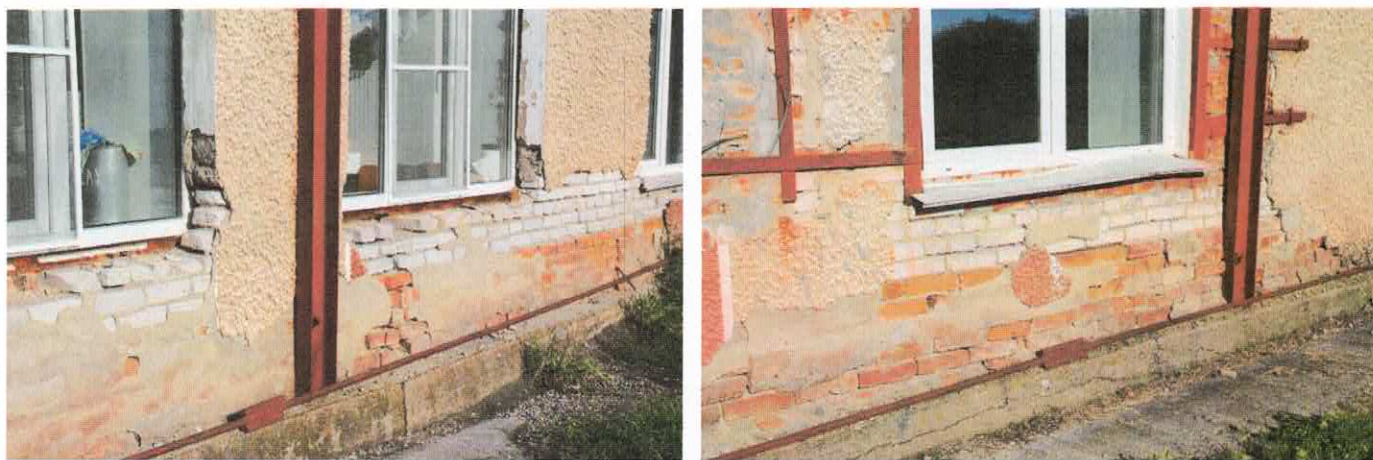
Фото 8.1.6.8.1.7 Участки разрушения наружной версты кладки в результате морозной деструкции, подвижность отдельных кирпичей
