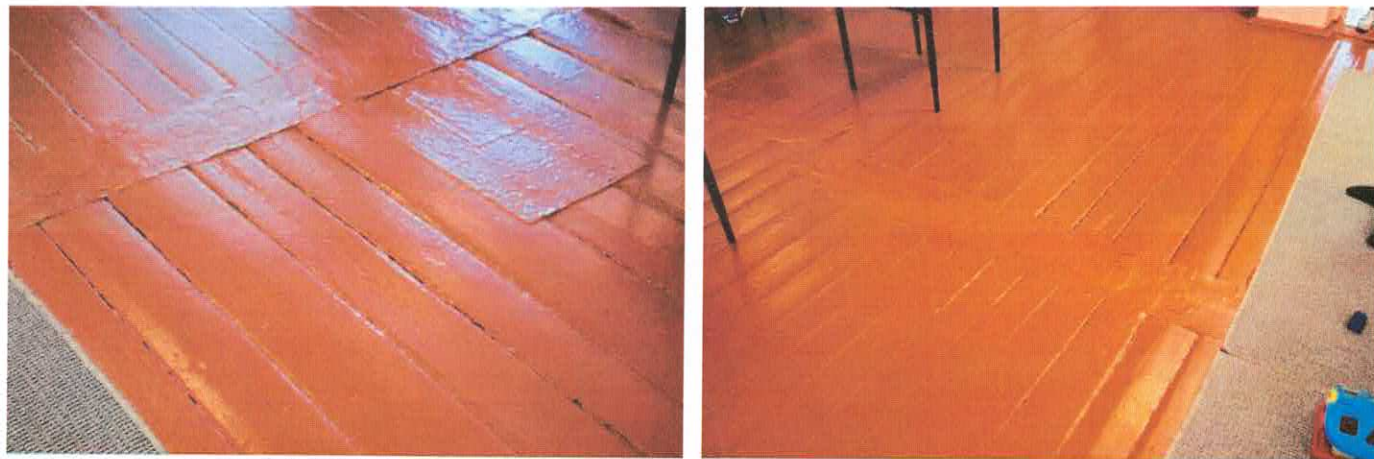
Фото 8.3.1,8.3.2 Общее техническое состояние деревянного дощатого пола
