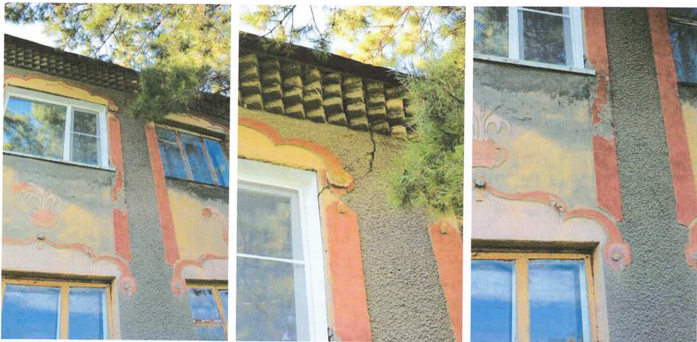
Фото 8.1.1-8.1.3 Трещины в кладке наружных стен
